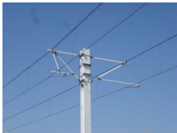
Podwieszenia sieci trakcyjnej
