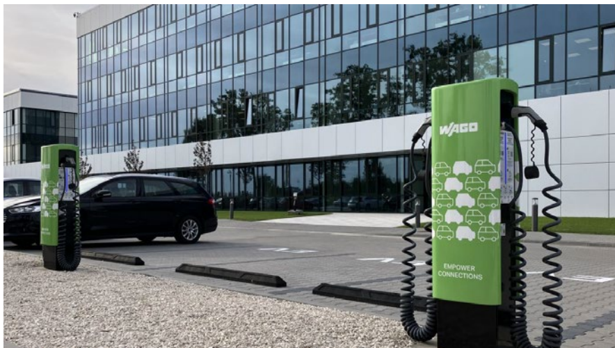
Fot.5 Stacja ładowania na terenie zakładu WAGO we Wróblowicach
