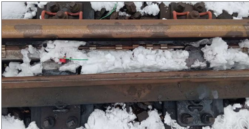
Fot. 30. Rozjazd nr 38 z radiatorami, strefa A, moc grzejników obniżona o 30%, stan po 28 minutach grzania. WYŁĄCZENIE grzania.
