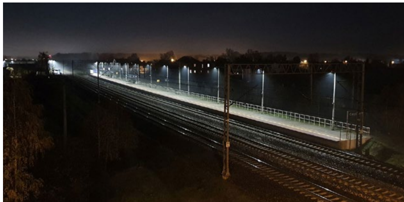
Rysunek 11 Instalacja demonstracyjna na stacji Cieplewo. Źródło: Archiwum AREX Sp. z o.o.
