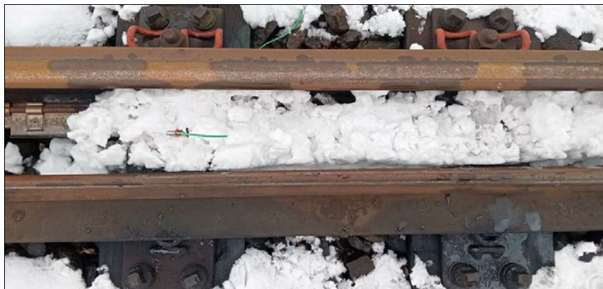
Fot. 28. Rozjazd nr 38 z radiatorami, strefa A, moc grzejników obniżona o 30%, stan po 15 minutach grzania.
