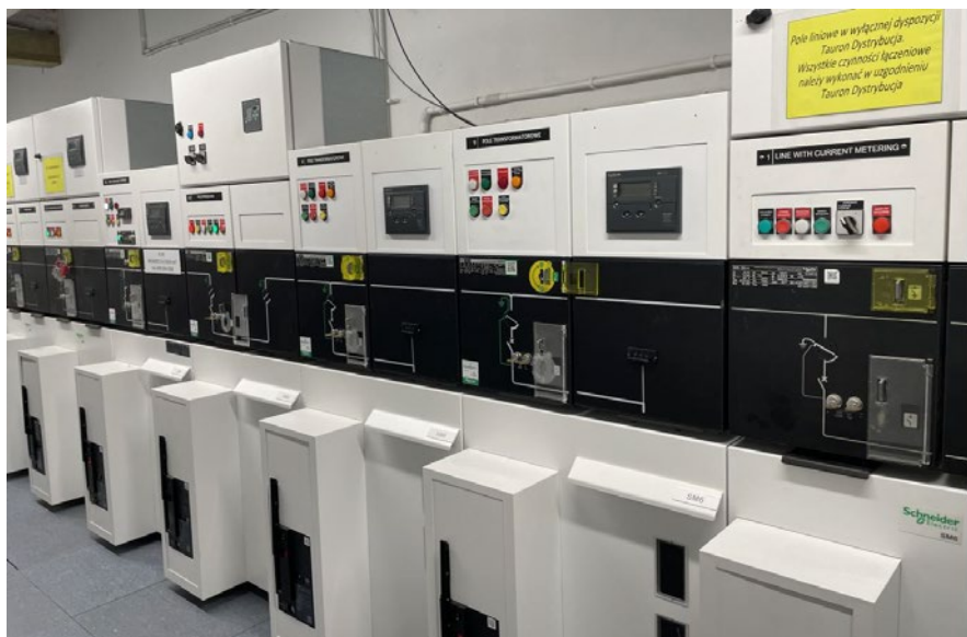
Fot.1 Rozdzielnica średniego napięcia SN
