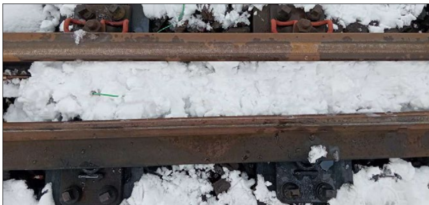
Fot. 26. Rozjazd nr 38 z radiatorami, strefa A, moc grzejników obniżona o 30%, stan zaśnieżenia przed rozpoczęciem grzania.
