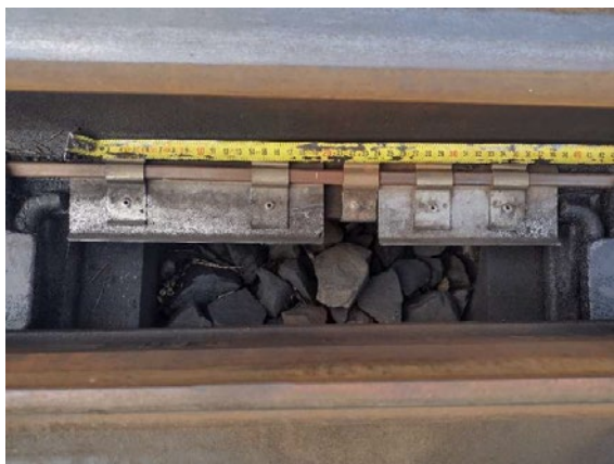
Fot. 2. Część rozjazdu wyposażona w grzejnik z zamontowanymi radiatorami (metoda bezstykowa).
