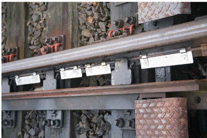
Fot. 18. Nakładki radiacyjne w rozjeździe nr 38, stacja Międzyzlesie
