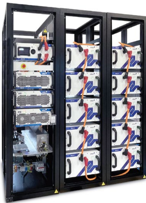
Zdjęcie 2: Moduł magazynu energii współpracujący z systemem SEMSRail wykonany jest w postaci kaset w standardzie RACK 19”.
