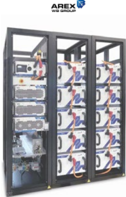
Magazyn Energii ARES BAT-01 SEMSRail
