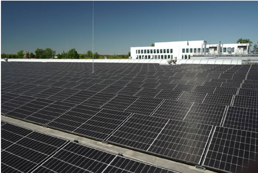
Fot.2 Instalacja fotowoltaiczna na dachu hali produkcyjnej WAGO
