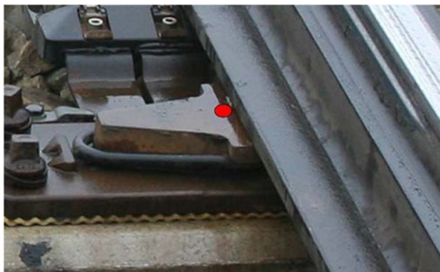
Fot. 17. Punkt pomiaru temperatury płyty ślizgowej krytyczny dla ogrzewania półzwrotnicy z iglicą dosuniętą.
