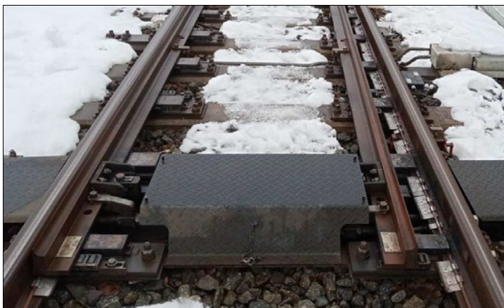
Fot.8. Rozjazd nr 11 na stacji Gdańsk Osowa z zabudowanymi nakładkami typu NR
