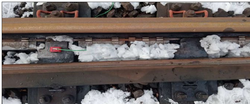
Fot. 32. Rozjazd nr 38 z radiatorami, strefa A, moc grzejników obniżona o 30%, stan po 57 minutach stygnięcia. Drugie ZAŁĄCZENIE grzania.
