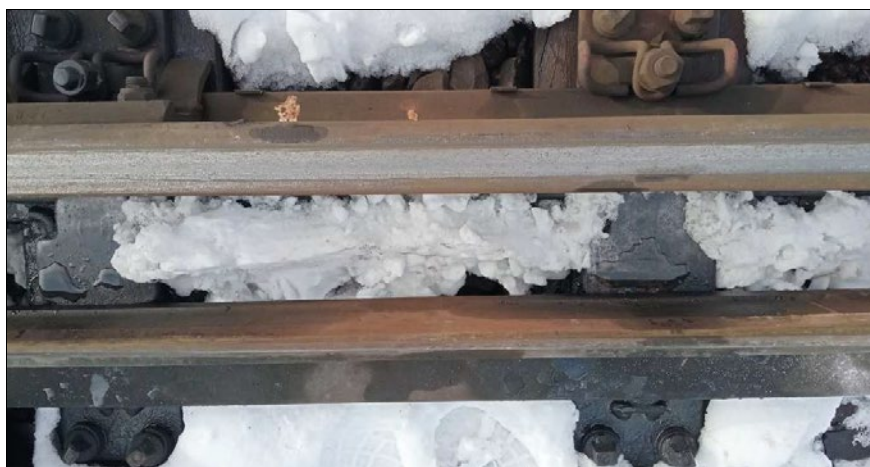
Fot. 33. Rozjazd nr 39 referencyjny, strefa A, moc grzejników 100%, stan po 57 minutach stygnięcia. Drugie ZAŁĄCZENIE grzania.
