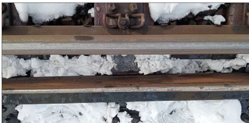
Fot. 41. Rozjazd nr 39 referencyjny, strefa B, stan po 27 minutach grzania. Moc grzejników 100%.
