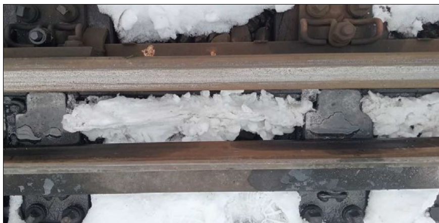
Fot. 35. Rozjazd nr 39 referencyjny, strefa A, moc grzejników 100%, stan po 20 minutach drugiego załączenia grzania.
