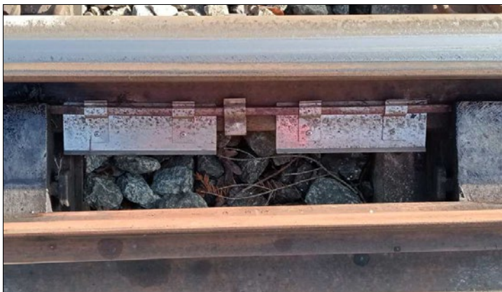
Fot.7. Nakładki NR-70/200 zabudowane na stacji Gdańsk Osowa.
