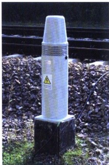
Urządzenie UOZ-1 zainstalowane przy torze kolejowym
