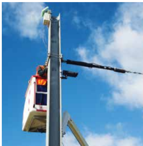
Fot. 6. Instalacja badanego gazowego urządzenia naprężającego AERO 1000
