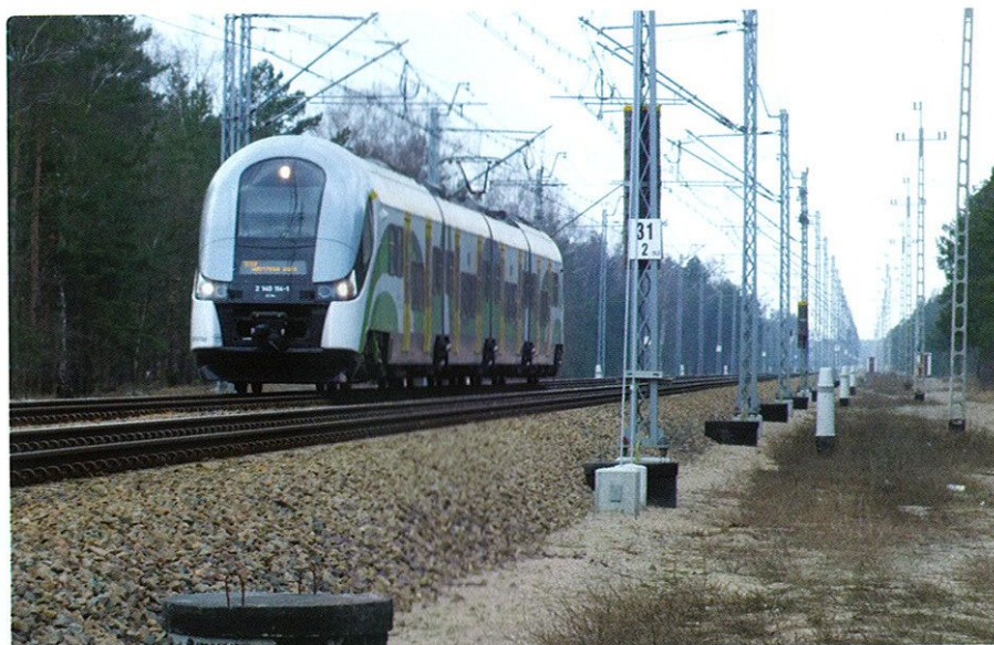
Instalacja Urządzenia Odstraszania Zwierząt UOZ-1
